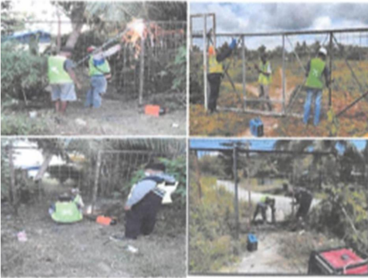
Gambar 4.1.2.1. 1 Proses pekerjaan penutupan pagar perimeter Sumber: PT. Angkasa Pura I (Persero) Biak
