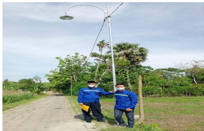
Gambar 4. Lampu penerangan telah terpasang
