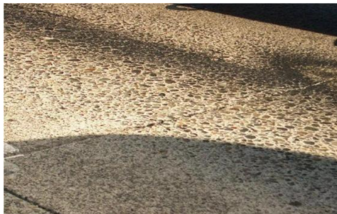
Gambar 3. 5 hilangnya kekesatan pada perkerasan (Sumber: slideshare.net/aguskerusakan-perkerasan-kaku )
