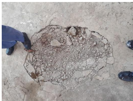
Gambar 4. 10 Kerusakan parkir PKP-PK Bandar Udara Melalan (Sumber: Dokumentasi Penulis, Tahun 2024)
