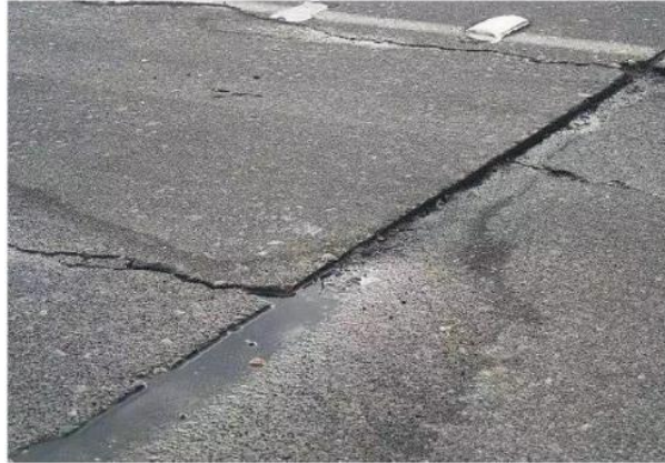
Gambar 3. 2 kerusakan pada joint
