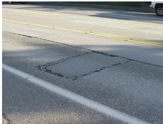
Gambar 3. 3 kerusakan pada tepi patching yang tidak sempurna
