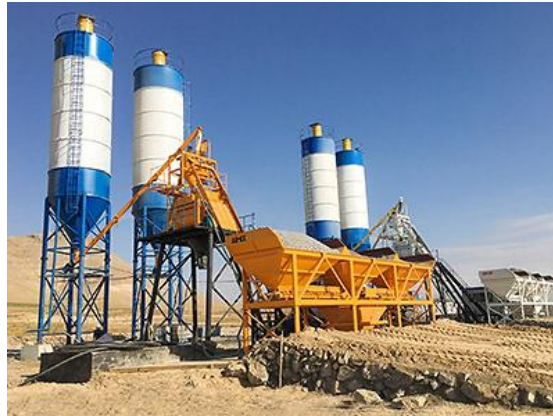
Gambar 4.25 Concrete Batching Plant (Sumber : https://www.aimix.id/ diakses pada tanggal 25 Desember 2024)
