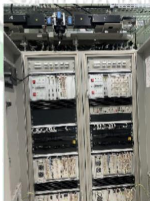
Pengecekan mingguan pada radar PSR CKG
