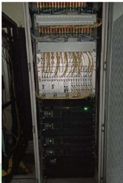
Gambar 3. 21 Server M-LAT Di Processing Room
