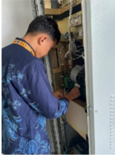
Gambar 3.56 Pemasangan kabel serial pada alat Sumber : Dokumentasi Penulis 5 Desember 2024
