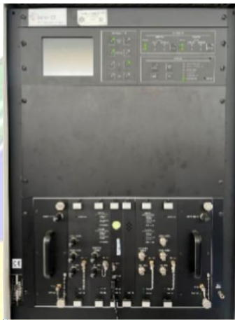
Gambar 3. 45 DME merk Selex Sumber : Perum LPPNPI Cabang JATSC,2024
