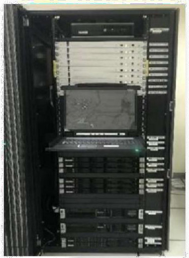
Gambar 3. 42 Server A-SMGCS Di Processing Room Sumber : Perum LPPNPI Cabang JATSC,2024
