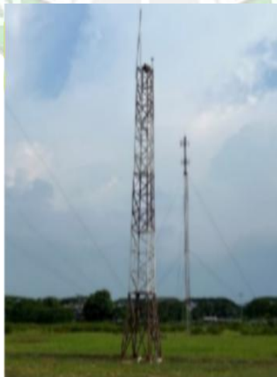
Gambar 3.4 Antena ATIS Sumber : Dokumentasi Penulis, 2024
