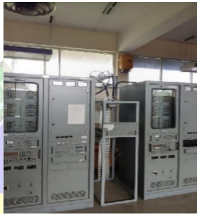
Gambar 3. 6 TX RDARA Di Gedung 720 Sumber : Dokumentasi Penulis 25 Oktober 2024
