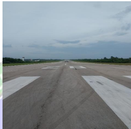
Gambar 4. 11 Kondisi Awal Landas Pacu Sebelum Overlay Sumber: Olahan Penulis, 2024
