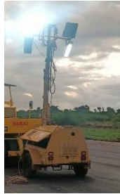
Gambar 4. 18 Lampu Penerangan Sumber: Olahan Penulis, 2024
