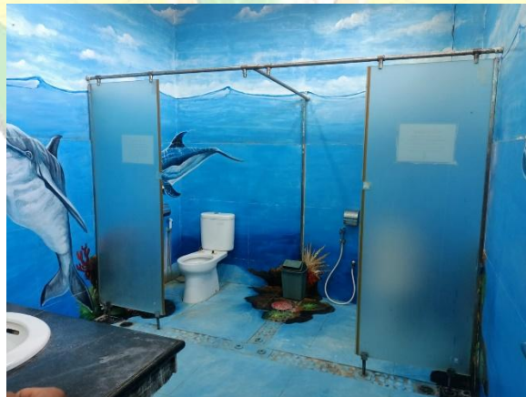
Gambar 4. 34 Kondisi Sebelum Perbaikan Partisi Sumber: Olahan Penulis, 2024
