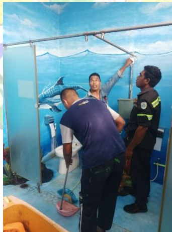
Gambar 4. 10 Kondisi Kerusakan Partisi Toilet Terminal Penumpang Sebelum Perbaikan Sumber: Olahan Penulis, 2024
