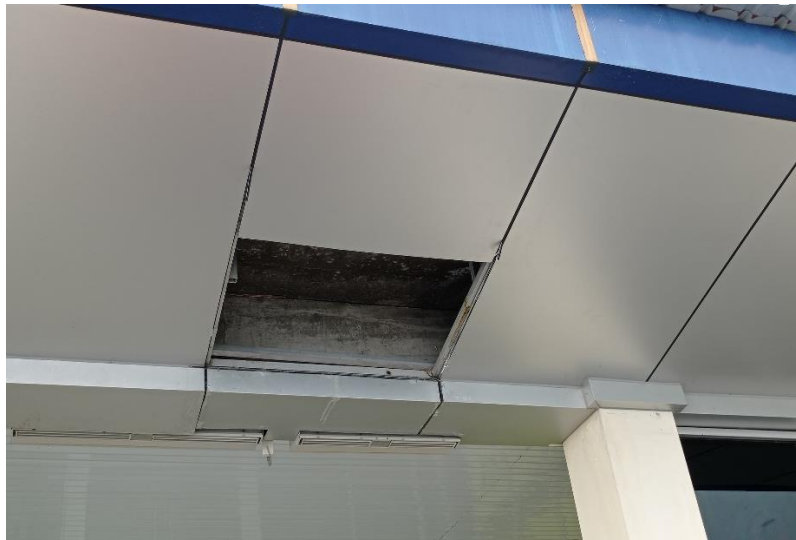
Gambar 4. 16 Kondisi kerusakan plafon pada terminal keberangkatan (Sumber: Dokumentasi Penulis, Tahun 2024)
