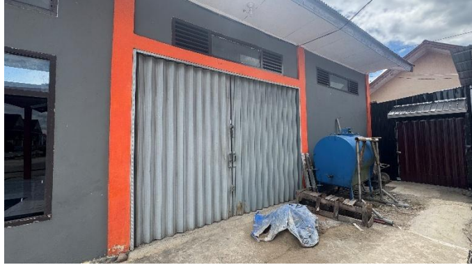
Gambar 3. 27 Gedung Genset atau Power House
