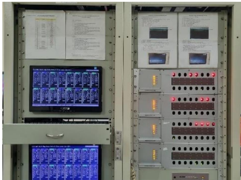
Gambar 3. 1 Server AMSC Merk ELSA Sumber : Dokumentasi Penulis
