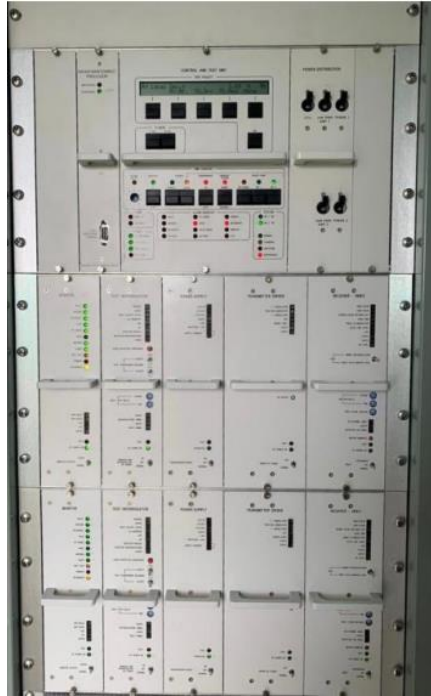
Gambar 3. 12 Transmitter DME Merk Interscan Sumber: Dokumentasi Penulis
