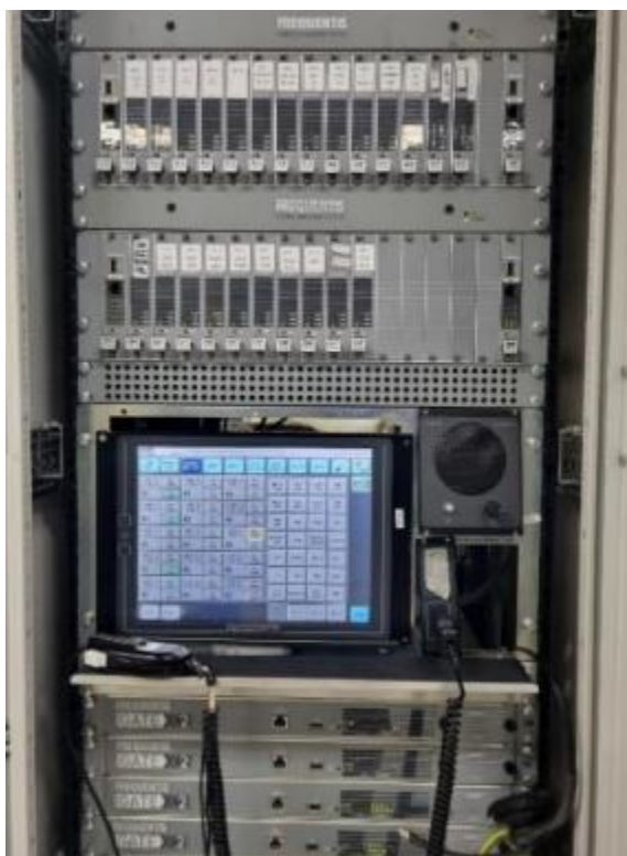
Gambar 3. 3 Server VCCS Merk FREQUENTIS Sumber : Dokumentasi Penulis
