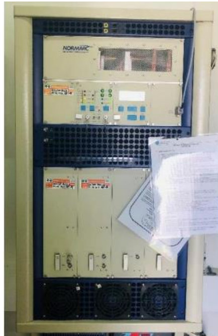
Gambar 3. 9 Glide Path Merk Normarc Sumber: Dokumentasi Penulis
