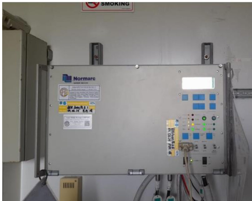
Gambar 3. 10 Peralatan Middle Marker Merk NORMAC Sumber: Dokumentasi Penulis
