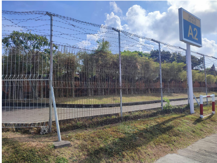
Gambar 4. 9 Kondisi pagar yang korosi atau berkarat
