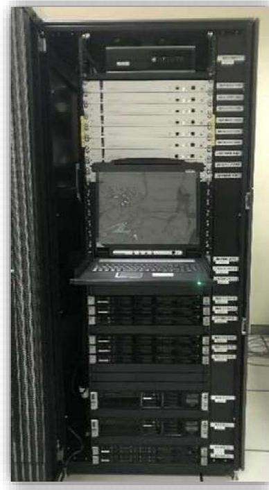
Gambar3. 40 Server A-SMGCS Di Processing Room
