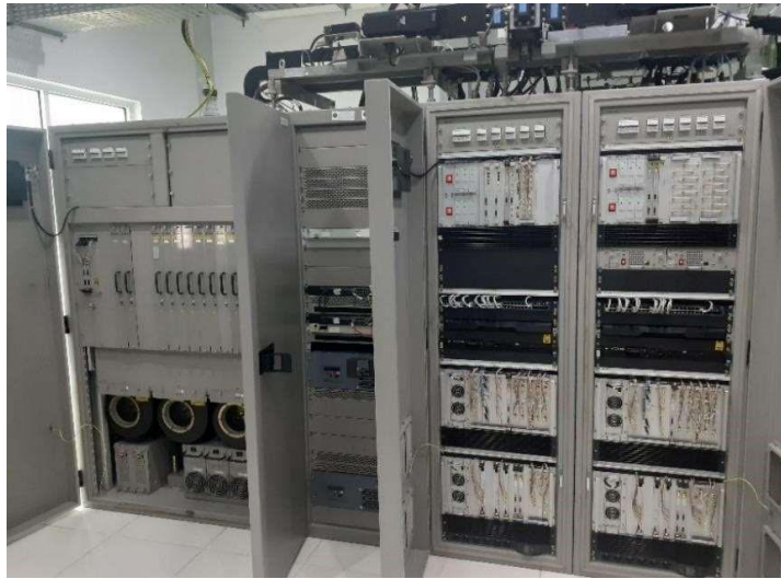
Gambar3. 19 Kabinet Pengelolah Data RADAR PSR
