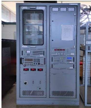
Gambar 3. 6 TX RDARA Di Gedung 720
