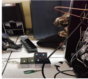
Gambar3. 47 Pelepasan battery UPS Sumber: Dokumentasi Penulis, 21 November 2024
