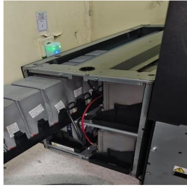
Gambar3. 46 Pelepasan battery UPS Sumber: Dokumentasi Penulis, 21 November 2024
