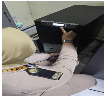
Gambar3. 52 Pengecekan indicator UPS Sumber: Dokumentasi Penulis, 21 November 2024
