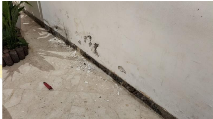
Gambar 4. 27 Cat Dinding yang mulai rusak
