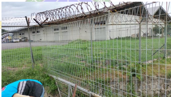
Gambar 4. 25 Pagar yang Rusak
