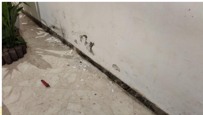
Gambar 4. 23 Cat Dinding yang Rusak
