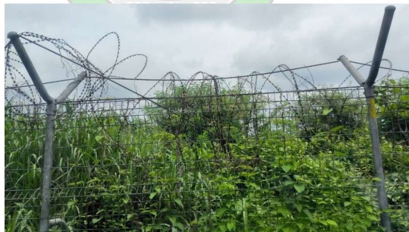
Gambar 4.6 Kawat Pagar Perimeter Yang Rusak
