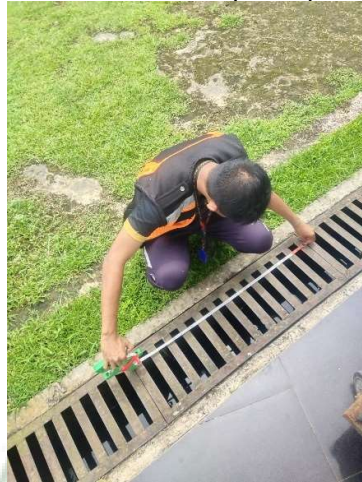
Gambar 4. 23 Grill besi penutup selokan
