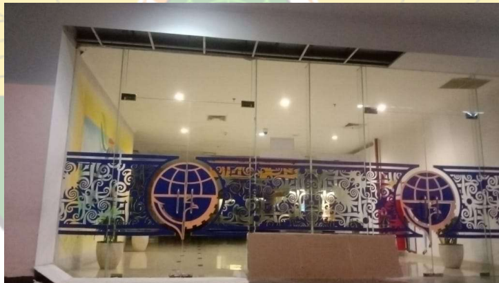
Gambar 4. 20 Kerusakan Plafon pada Gedung Terminal (Sumber : Dokumentasi Penulis, 2024)
