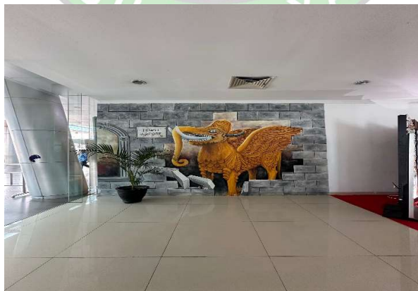
Gambar 4. 22 Kondisi Dinding sebelum pengecatan ulang pada Gedung Terminal
