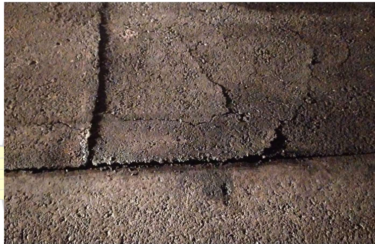
Gambar 3. 2 Kerusakan Rutting Pada Perkerasan Lentur (sumber : Dokumentasi penulis tahun, 2025)
