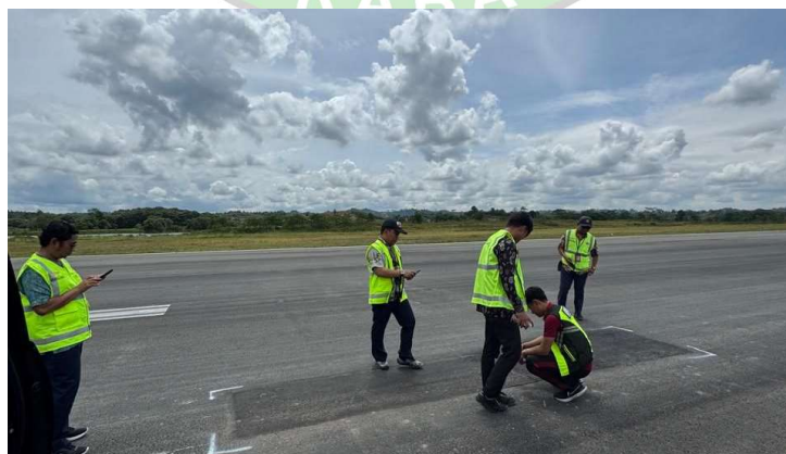
Gambar 4. 24 Kegiatan Pengukuran terhadap Kerusakan (Sumber : Dokumentasi Penulis, 2025)
