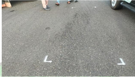
Gambar 4.18 Kerusakan Slippage Crack (Sumber : Dokumentasi Penulis, 2024)
