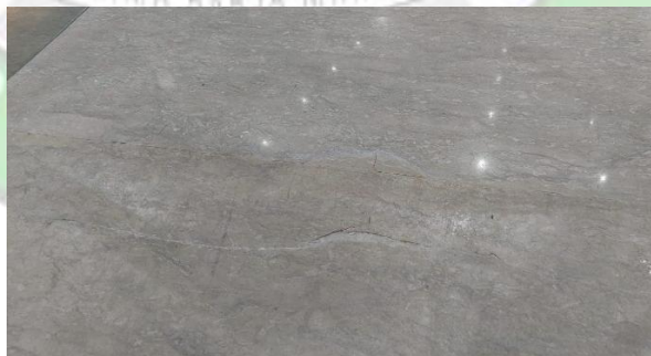
Gambar 4.19 Kerusakan Lantai Fixed Bridge 1 (Sumber : Dokumentasi Penulis, 2024)
