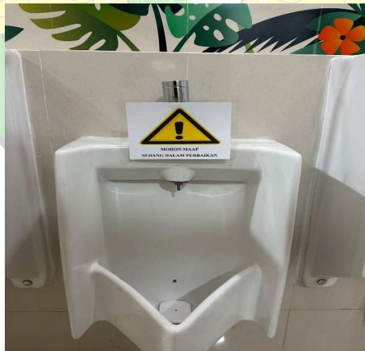
Gambar 4. 20 Kerusakan Urnioir Pada Toilet Terminal
