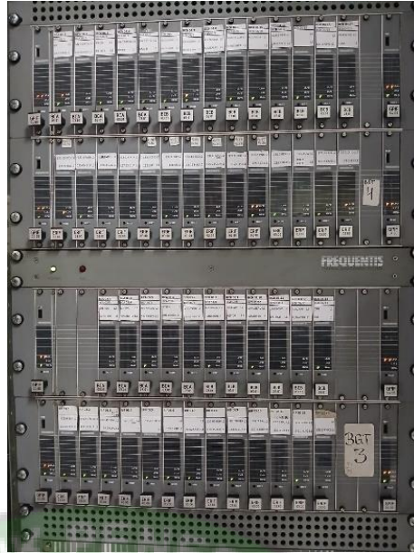
Gambar 3.9 Server VCCS Frequentis Sumber: Hasil Dokumentasi Penulis 2024
