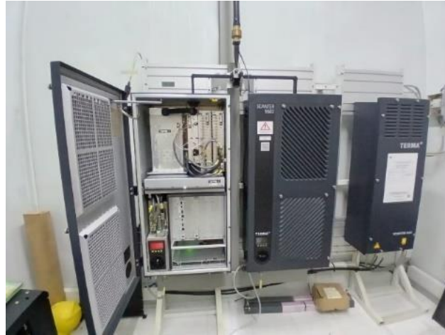
Gambar 3.52 Kabinet Peralatan SMR di shelter Sumber: Hasil Dokumentasi Penulis 2024
