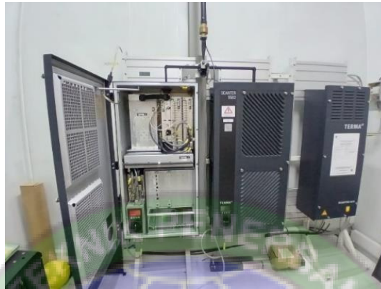
Gambar 3.44 Redundant Tranceiver SCANTER 5502 di shelter T1 dan T3 Sumber: Hasil Dokumentasi Penulis 2024
