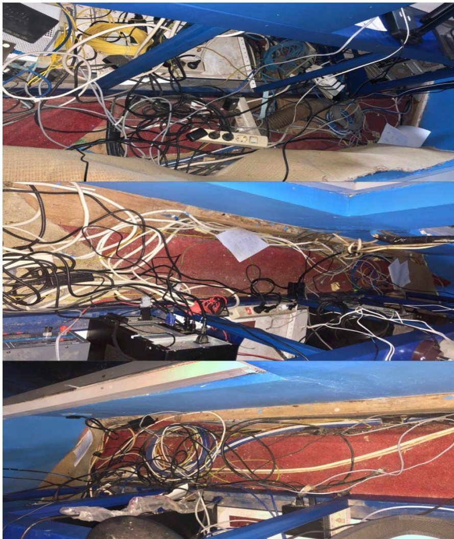
Gambar 4. 1 Kabel Yang Tidak tersusun rapi di Belakang Desk Control
