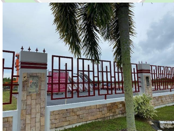
Gambar 4. 13 Pagar Yang Tidak Sesuai Pada perbatasan Kantor
