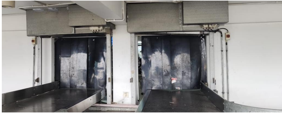
Gambar 4. 22 Rolling Door Breakdown Area (Sumber : Dokumentasi Penulis)
