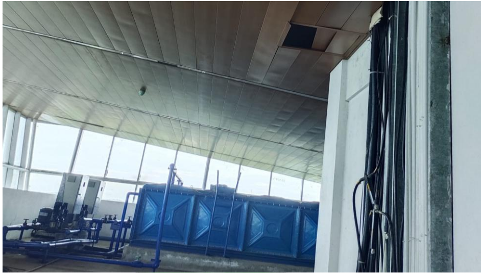
Gambar 4. 20 Penemuan Lokasi Celah Pada Atap di Area Ruang Tunggu (Sumber : Dokumentasi Penulis)
