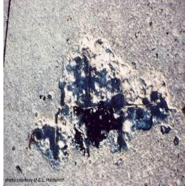
Gambar 3. 10 Kerusakan Popouts (Sumber : www.google.com 2024)
