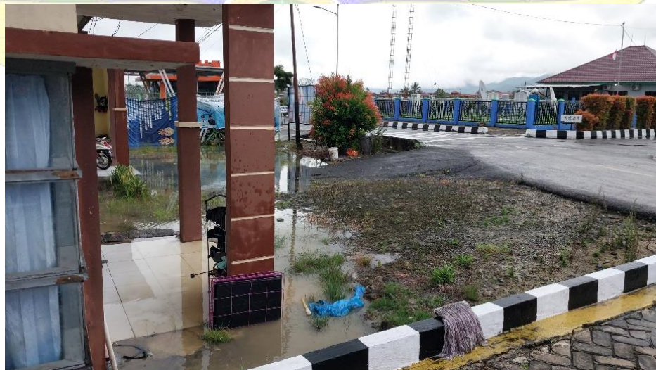
Gambar 4.6 Kondisi Rumah Dinas setelah Hujan
