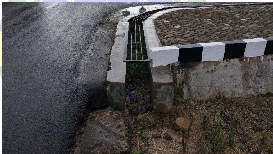
Gambar 4.8 Kondisi Saluran Drainase Eksisting
