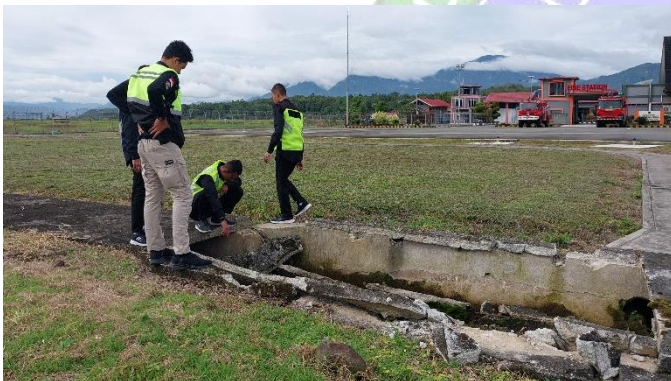
Memeriksa kerusakan tutup drainase sisi udara
