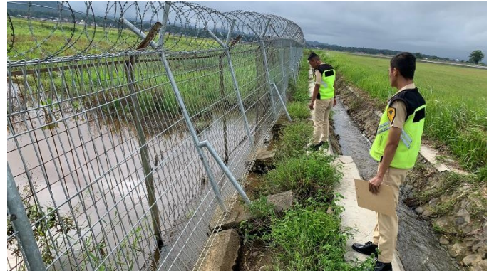
Mengukur bronjong pagar yang rusak
