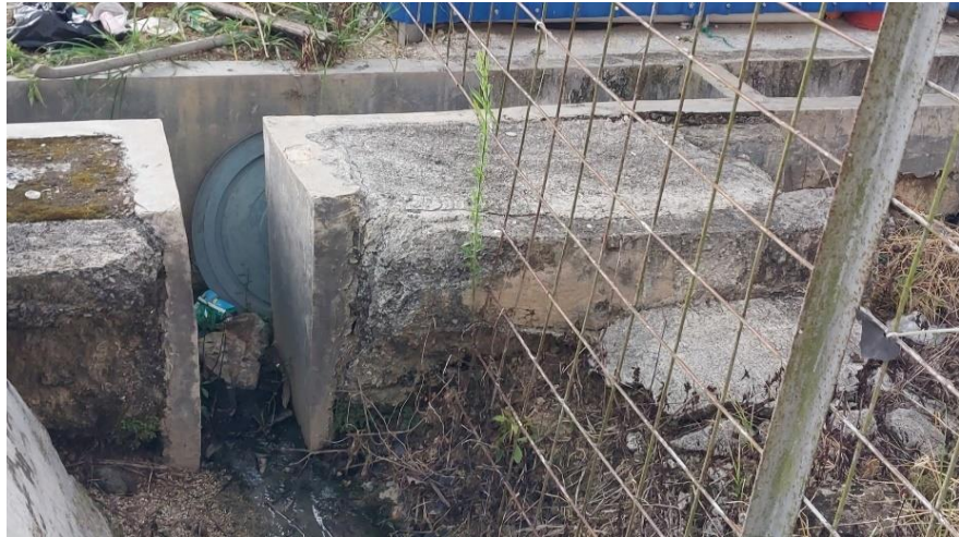
Gambar 4.7 Kondisi Saluran Drainase Eksisting
