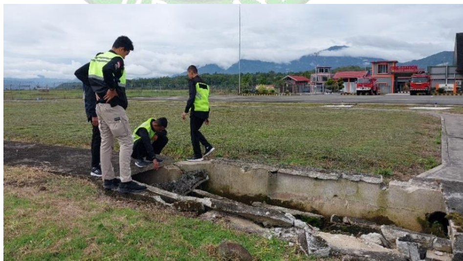
Gambar 4.5 Kondisi Tutup Saluran Drainase
