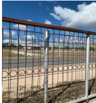
Gambar 4.18 Kondisi pagar area kantor dan rumah dinas (Sumber: Dokumentasi Pribadi, 2023)
