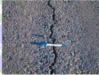
Gambar 3.2 Rusak sedang (Sumber: KP 94 tahun 2015)
