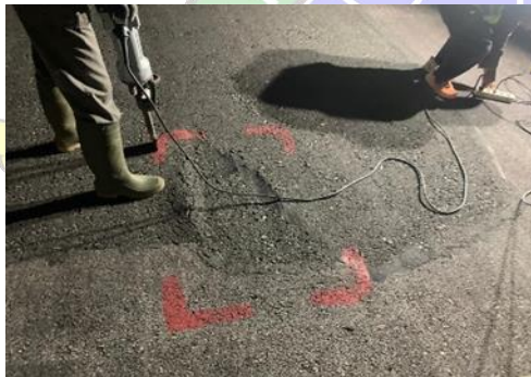
Gambar 4.17 Titik kerusakan taxiway (Sumber: Dokumentasi pribadi, 2023)
