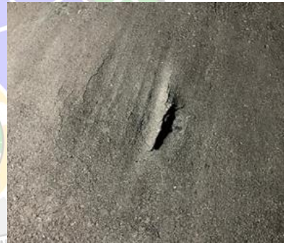
Gambar 4.18 Titik kerusakan runway (Sumber: Dokumentasi pribadi, 2023)
