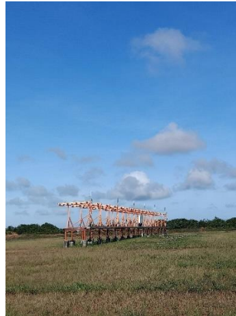
Gambar 3. 22 Antenna Localizer Sumber : Dokumentasi Penulis (2023)
