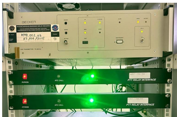
Gambar 3. 31 Pengecekan Indikator Pemancar
