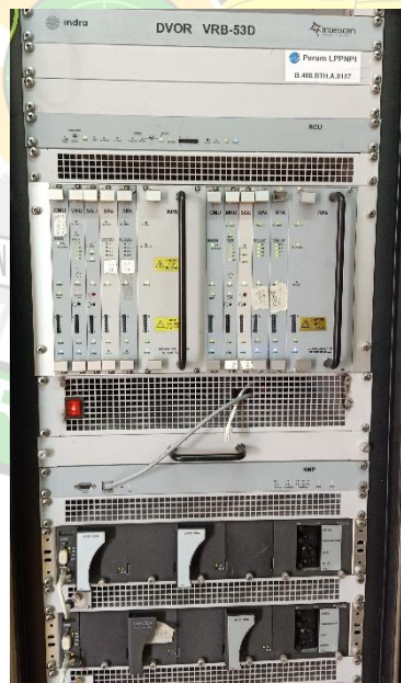
Gambar 3. 13 Peralatan DVOR Sumber : Dokumentasi Penulis (2023)
