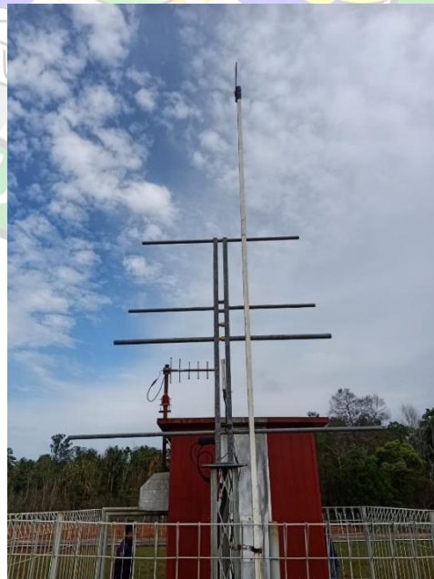
Gambar 3. 18 Antenna Middle Marker Sumber : Dokumentasi Penulis (2023)
