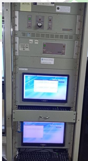
Gambar 3. 1 Peralatan ATIS Sumber : Dokumentasi Penulis, (2023)
