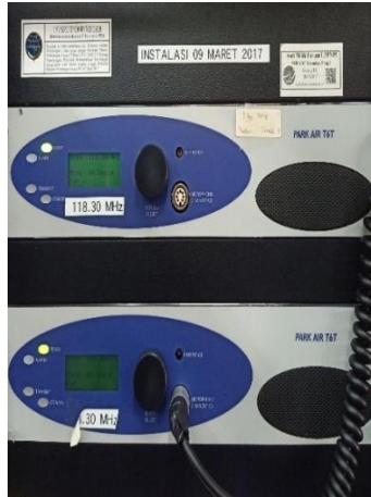
Gambar 3. 7 VHF A/G Secondary Transmitter Sumber : Dokumentasi Penulis, 2023
