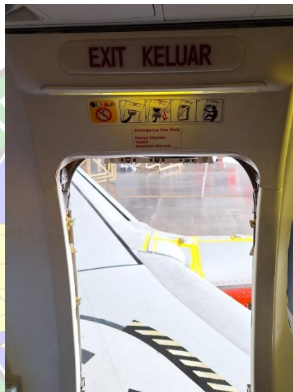
Gambar 4. 4 Emergency Light Escape Hatch (sumber: dokumentasi pribadi)
