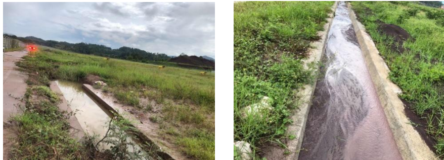
Gambar 4.1 Kondisi Tergenangnya Air pada Drainase (Sumber Dokumentasi Penulis)
