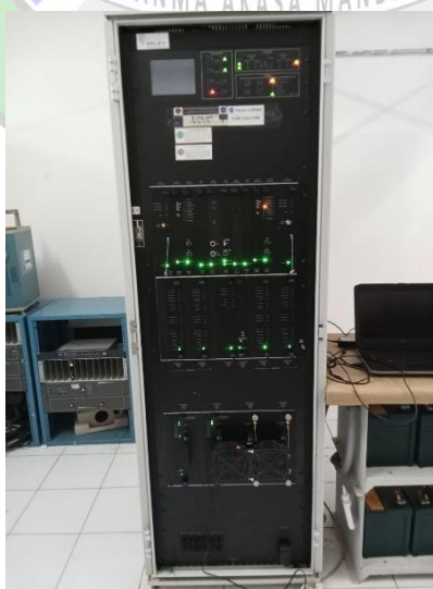
Gambar 3.11 Peralatan DVOR Sumber : Dokumentasi Penulis
