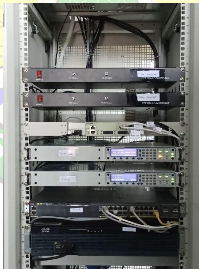
Gambar 3.8 VSAT Sumber : Dokumentasi Penulis
