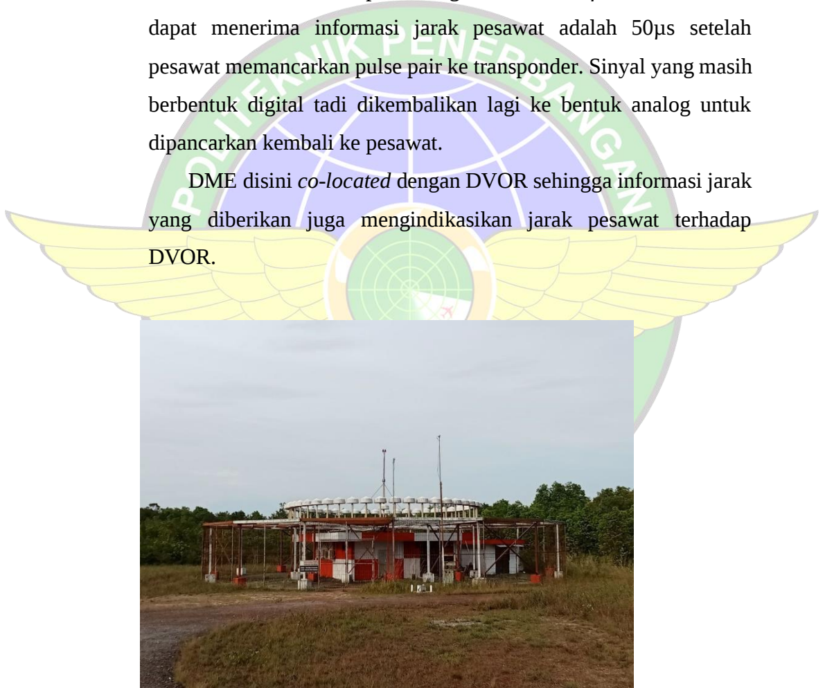
Gambar 3.13 ANTENA DME Sumber : Dokumentasi Penulis
