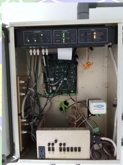
Gambar 3.24 Peralatan Middle Marker Sumber : Dokumentasi Penulis
