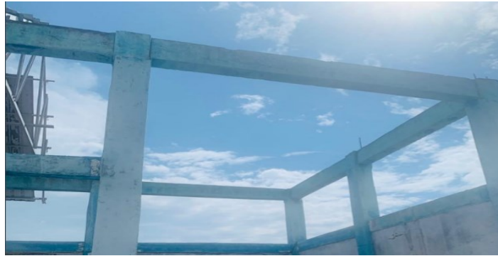
Gambar 4. 12 Kerusakan Atap Gedung Worlshop (Sumber : olahan penulis, 2023)
