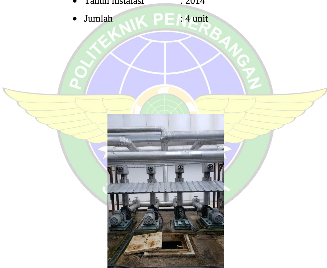
Gambar 2. 35 Pompa Chiller Sumber : Bandara Internasional Juwata Tarakan
