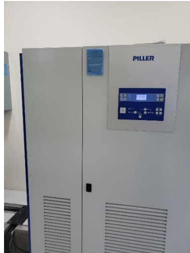
Gambar 2. 11 UPS 160 KVA Sumber : Bandara Internasional Juwata Tarakan
