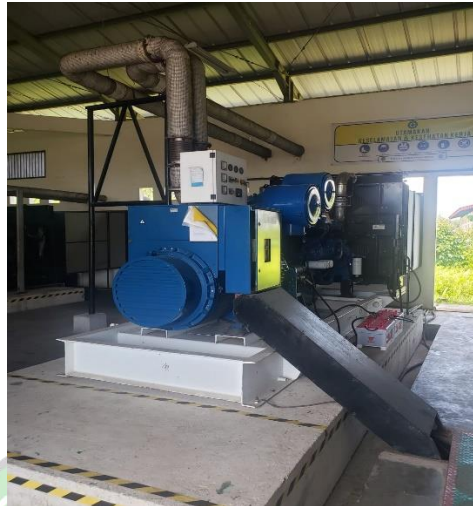
Gambar 2. 7 Genset 1000 KVA di PH Baru Sumber : Bandara Internasional Juwata Tarakan
