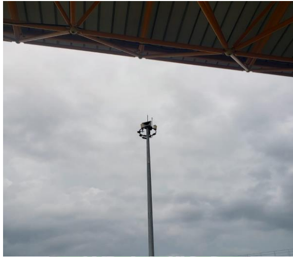
Gambar 2. 25 Flood Light Tiang Tunggal Sumber : Bandara Internasional Juwata Tarakan
