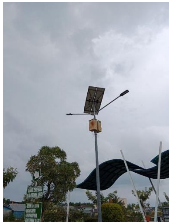
Gambar 4. 1 Lampu PJU Solar Cell Sumber : Bandar Udara Juwata Tarakan
