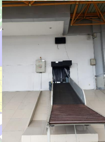
Gambar 2. 45 Conveyor Luar Sumber : Bandara Internasional Juwata Tarakan
