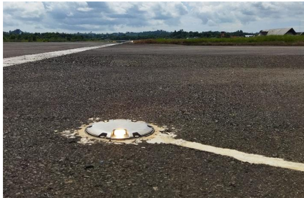
Gambar 2. 19 Runway Edge Light Inset Sumber : Bandara Internasional Juwata Tarakan
