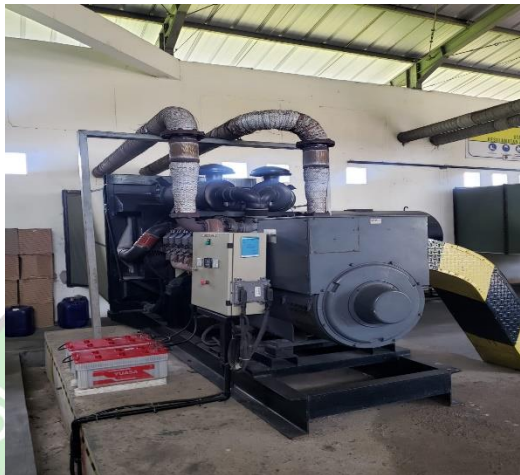
Gambar 2. 8 Genset 500 KVA di PH Baru Sumber : Bandara Internasional Juwata Tarakan
