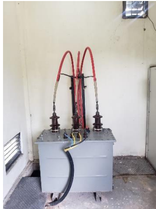
Gambar 2. 15 Trafo Step Down 50 KVA Sumber : Bandara Internasional Juwata Tarakan
