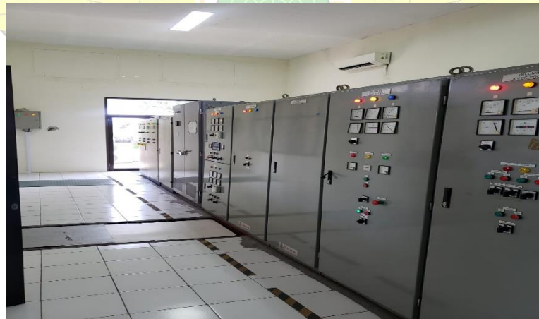
Gambar 2. 17 Panel Utama (ACOS, Transmisi, dan Distribusi) di PH Baru Sumber : Bandara Internasional Juwata Tarakan
