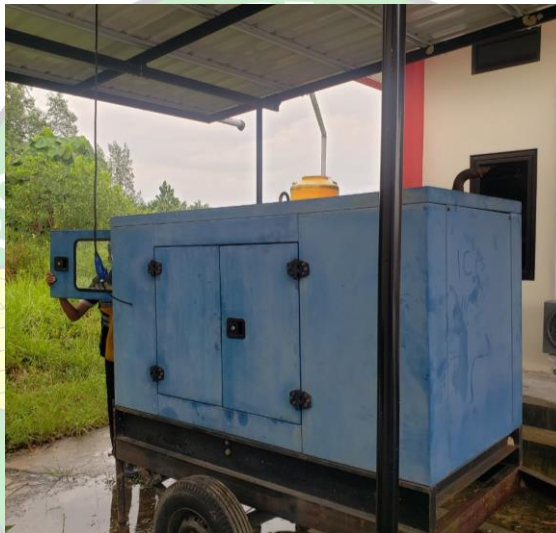
Gambar 2. 9 Genset Mobile 25 KVA Sumber : Bandara Internasional Juwata Tarakan
