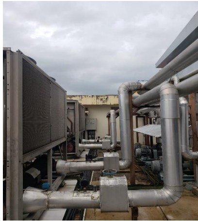
Gambar 2. 393 Unit Chiller Sumber : Bandara Internasional Juwata Tarakan
