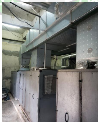
Gambar 2. 41 AHU 50 PK Sumber : Bandara Internasional Juwata Tarakan
