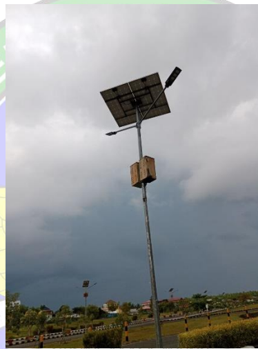
Gambar 4. 3 Lampu PJU Solar Cell Sumber : Bandar Udara Juwata Tarakan
