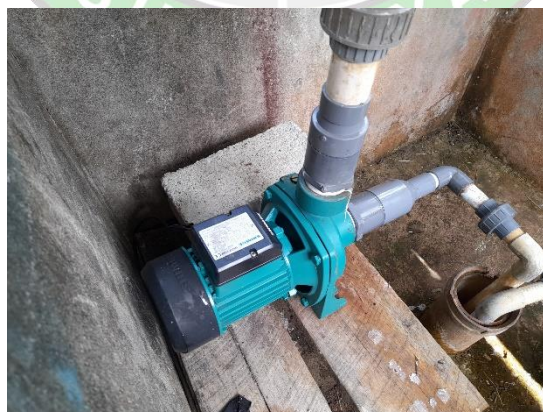
Gambar 2. 38 Pompa Shimge Sumber : Bandara Internasional Juwata Tarakan
