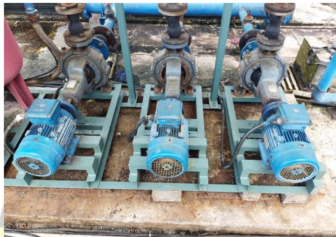
Gambar 2. 36 Pompa Booster Sumber : Bandara Internasional Juwata Tarakan
