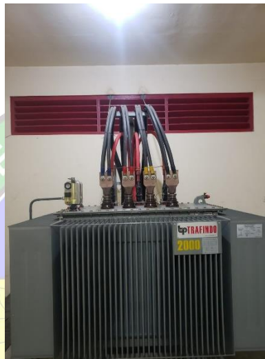
Gambar 2. 14 Trafo Step Down 2000 KVA Sumber : Bandara Internasional Juwata Tarakan
