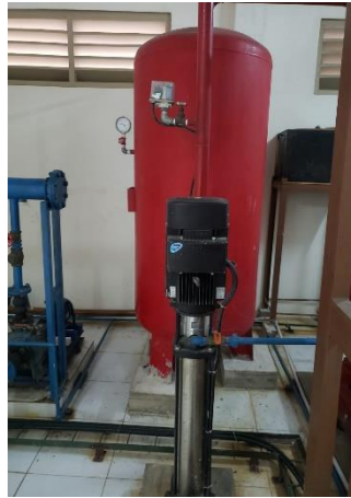
Gambar 2. 33 Pompa Joki Hydrant Sumber : Bandara Internasional Juwata Tarakan
