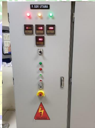
Gambar 2. 16 Panel SDP Utama Sumber : Bandara Internasional Juwata Tarakan
