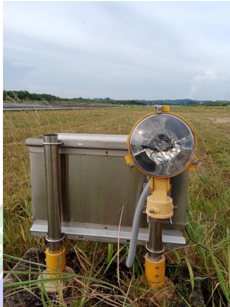
Gambar 2. 29 RTIL Sumber : Bandara Internasional Juwata Tarakan
