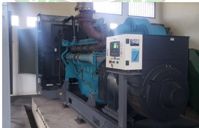
Gambar 2. 6 Genset 1000 KVA di PH Baru Sumber : Bandara Internasional Juwata Tarakan
