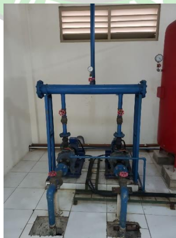
Gambar 2. 34 Pompa Transfer Sumber : Bandara Internasional Juwata Tarakan
