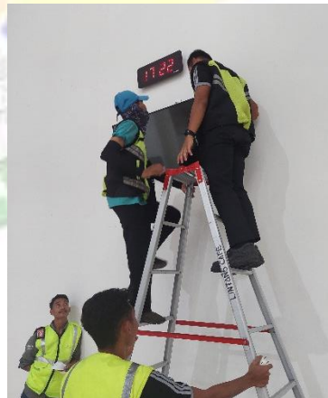
Pengecekan Power TV di Terminal
