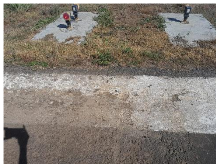
Gambar 4. 9 Kondisi Marka Runway yang mengelupas
