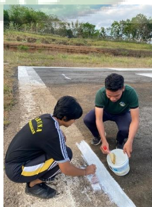
Gambar 4.14 Pengecatan ulang marka runway yang terkelupas
