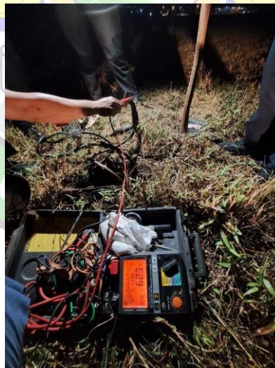
Gambar 4. 2 Pengukuran Tahanan Isolasi Lampu Runway Edge Circuit 2
