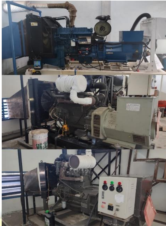
Gambar 2. 8 Genset 250kVA, 150kVA, dan 75kVA Sumber: Bandara UPBU H. Asan Sampit
