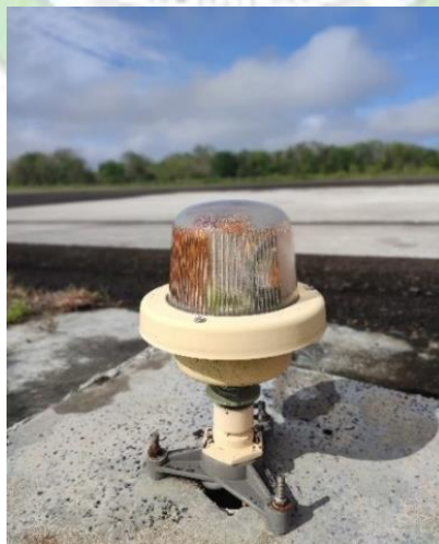
Gambar 2. 19 Runway Edge Light Elevated Sumber: Bandar Udara H. Asan Sampit
