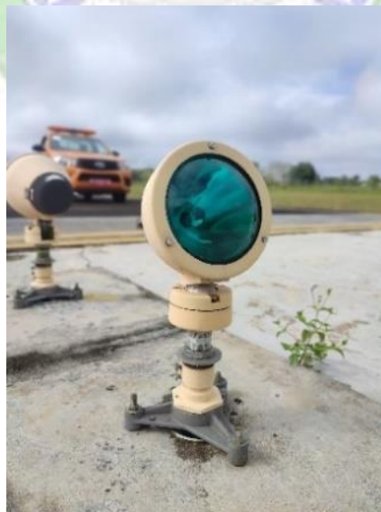
Gambar 2. 18 Threshold Light Sumber: Bandar Udara H. Asan Sampit
