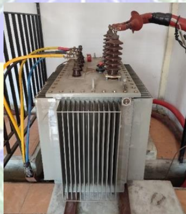
Gambar 2. 5 Transformator Sumber : Bandar Udara H. Asan Sampit
