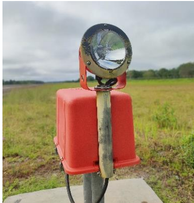
Gambar 2. 23 Konstruksi Runway Threshold Identification Light Sumber: Bandar Udara H. Asan Sampit
