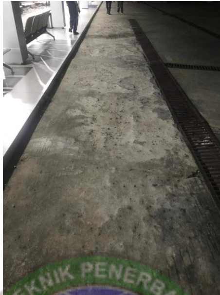
Gambar 4. 11 Area Kerusakan Pelat Beton Drop Zone
