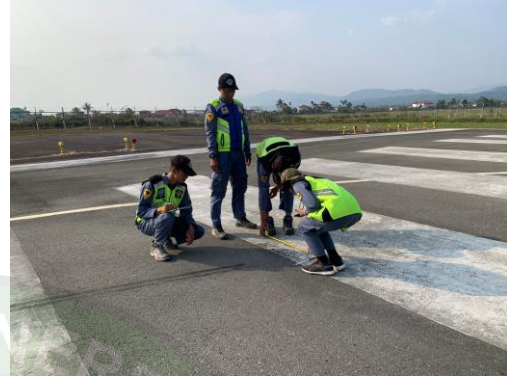
Pengukuran luas kerusakan pada runway untuk laporan PCI
