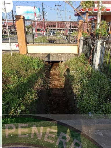
Gambar 4. 11 Drainase Tepi Jalan
