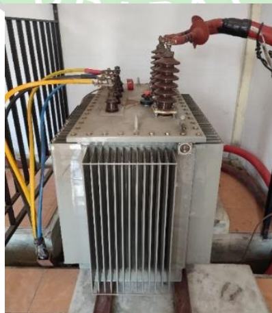
Gambar 2.3 Transformator Sumber: Bandara UPBU H. Asan Sampit
