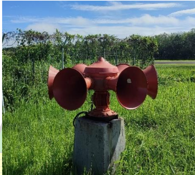
Gambar 2.27 Konstruksi Sirine Sumber: Bandara UPBU H. Asan Sampit
