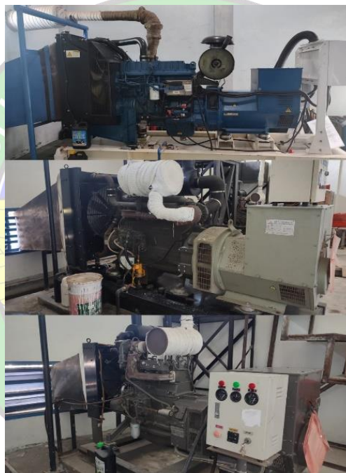
Gambar 2.6 Genset 250kVA, 150kVA, dan 75kVA Sumber: Bandara UPBU H. Asan Sampit
