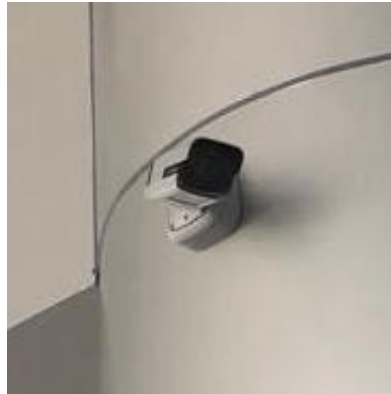
Gambar 3. 13 CCTV Bosh Sumber: Dokumentasi Penulis, 13 Februari 2024
