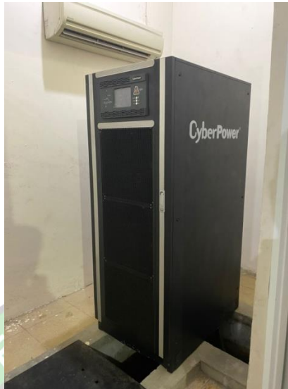
Gambar 2. 6 UPS 80 KVA Sumber : Bandara Sultan Muhammad Salahuddin Bima
