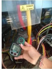
Gambar 4. 17 Ukur kembali arus yang telah di Re Instalasi
