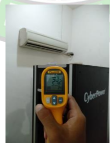
Gambar 4. 19 Check suhu ruangan khusus UPS
