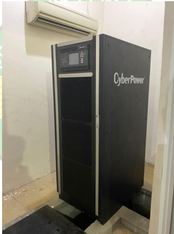
Gambar 3. 1 UPS 80 KVA Sumber: Bandar Udara Sultan Muhammad Salahuddin Bima
