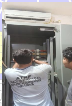
Gambar 4. 12 Lepas CB Tower yang di backup oleh UPS
