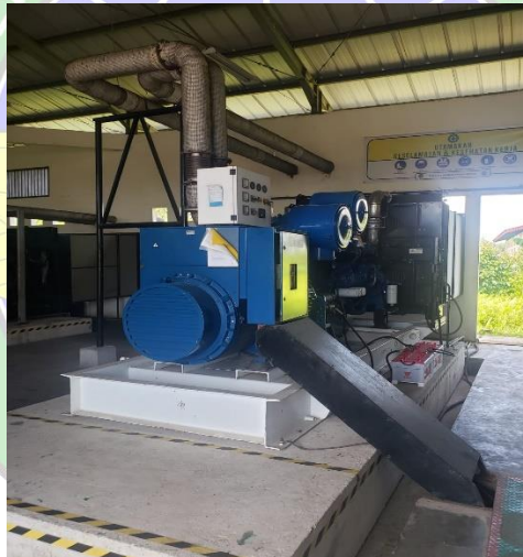
Gambar 2. 7 Genset 1000 kVA di PH Baru Sumber : Bandara Juwata Tarakan
