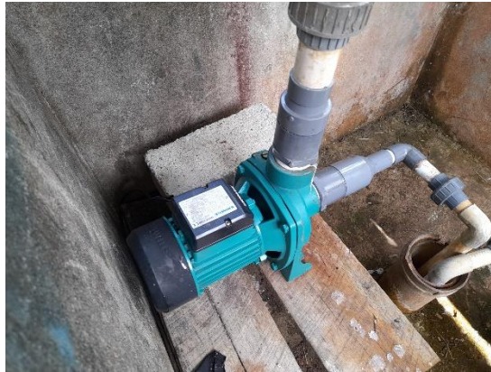
Gambar 2. 38 Pompa Shimge Sumber : Bandara Juwata Tarakan
