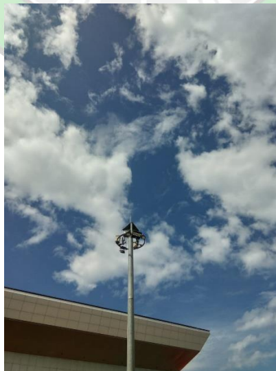
Gambar 2. 25 Flood Light Tiang Tunggal Sumber : Bandara Juwata Tarakan
