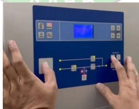
Gambar 4. 9 Pemutusan input PLN Sumber : Bandara Juwata Tarakan
