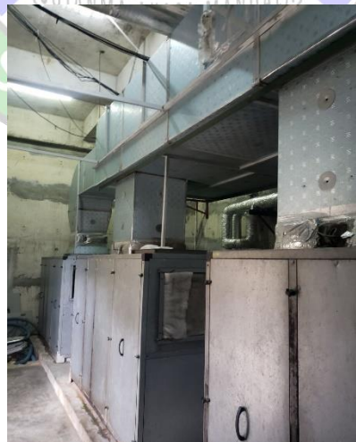
Gambar 2. 41 AHU 50 PK Sumber : Bandara Juwata Tarakan
