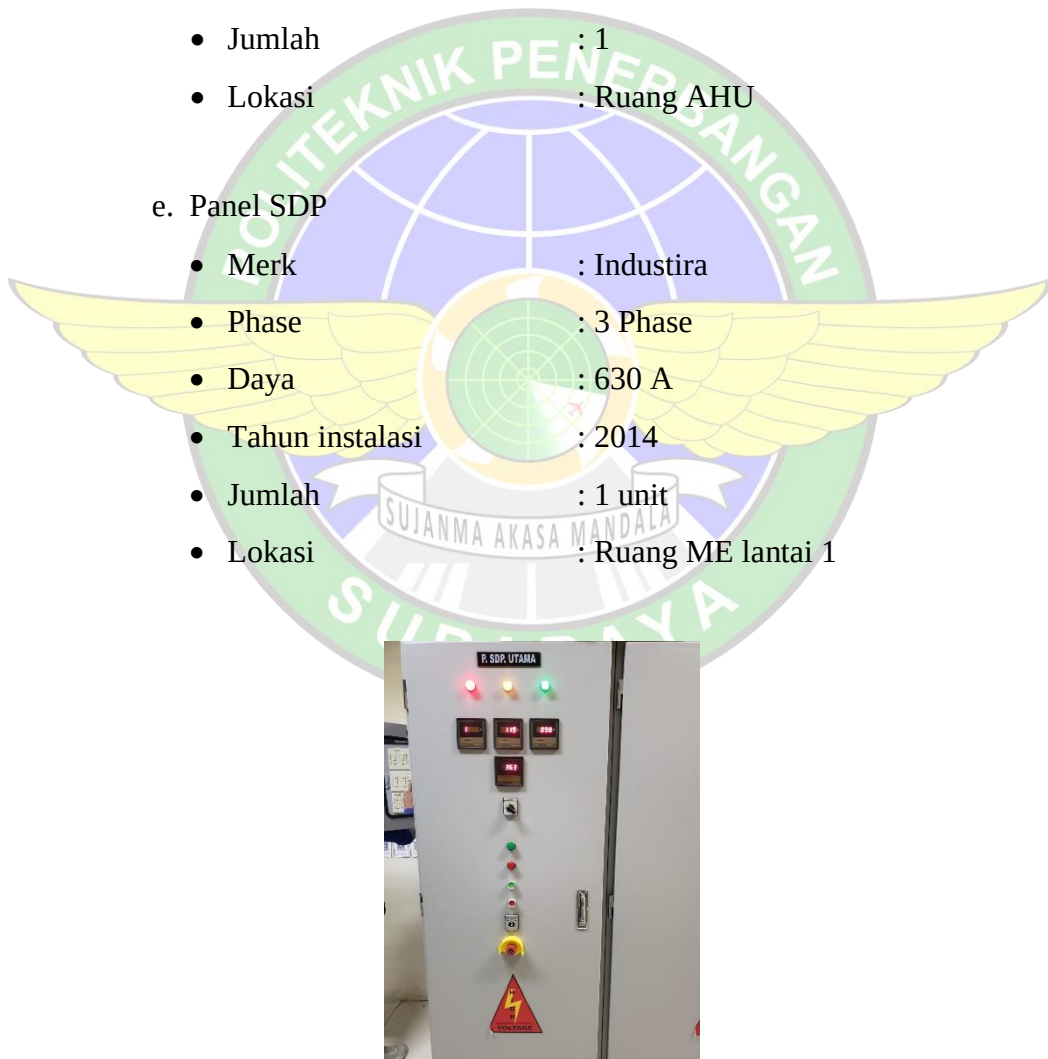
Gambar 2. 16 Panel SDP Utama Sumber : Bandara Juwata Tarakan
