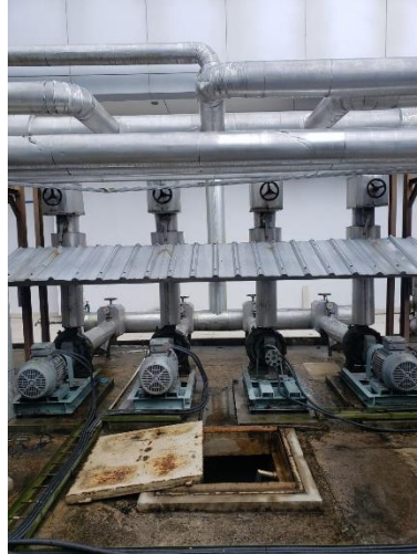
Gambar 2. 35 Pompa Chiller Sumber : Bandara Juwata Tarakan
