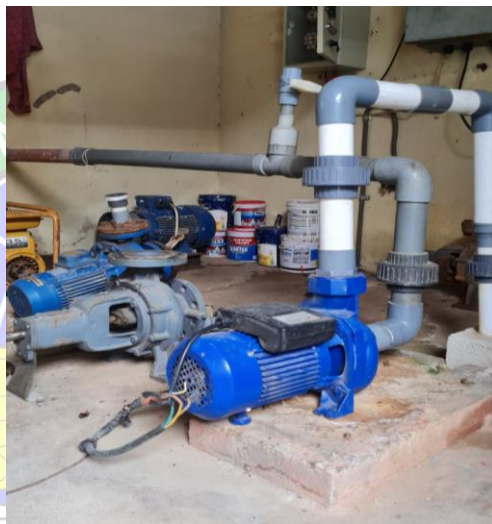
Gambar 2. 37 Pompa Ebara Sumber : Bandara Juwata Tarakan
