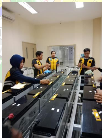
Gambar 4. 3 Penomoran Busbar dan Baterai UPS 80KVA terminal Sumber : Bandara Juwata Tarakan
