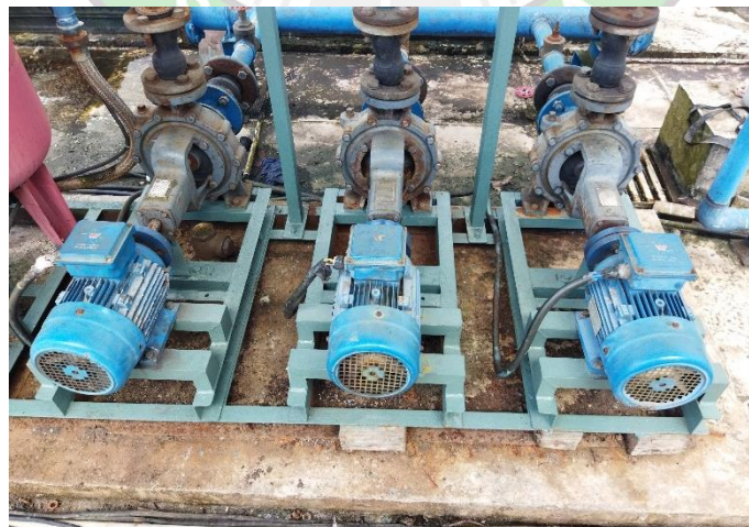
Gambar 2. 36 Pompa Booster Sumber : Bandara Juwata Tarakan
