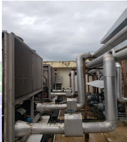
Gambar 2. 39 3 Unit Chiller Sumber : Bandara Juwata Tarakan
