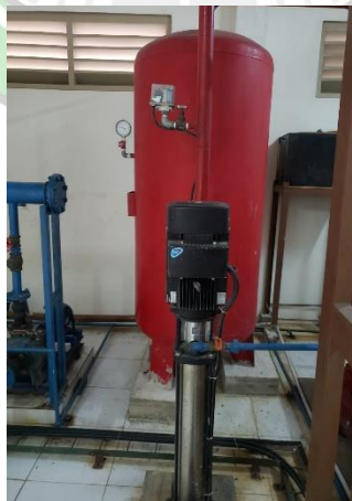
Gambar 2. 33 Pompa Joki Hydrant Sumber : Bandara Juwata Tarakan
