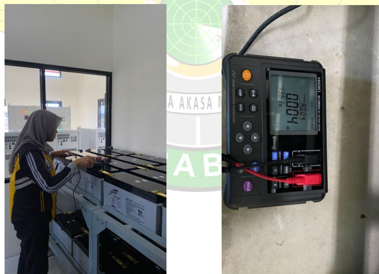
Gambar 4. 13 Pengecekan dan pengukuran resistansi dan tegangan masing-masing baterai Sumber : Bandara Juwata Tarakan
