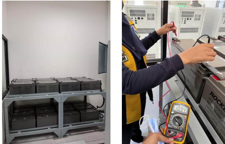
Gambar 4. 1 Pengecekan nilai resistansi dan tegangan pada baterai UPS 160kVA Gedung Substation
