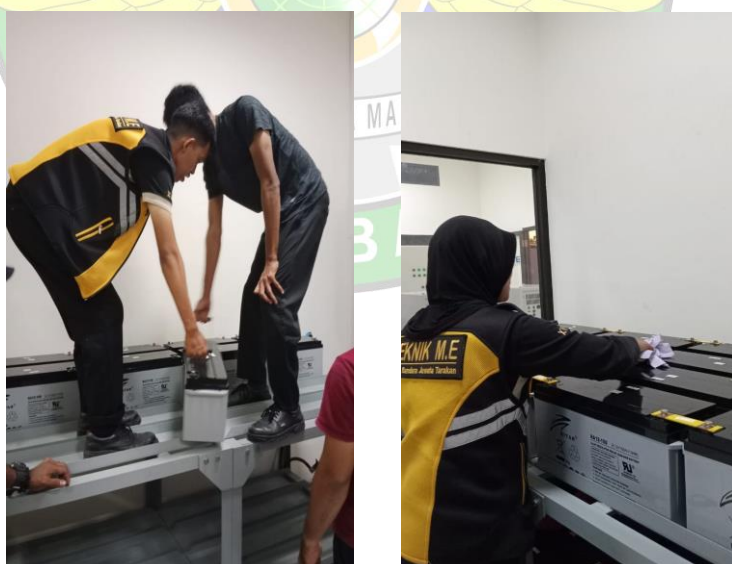
Gambar 4. 7 Proses pemasangan baterai RITAR pada UPS 160KV Gedung Substation
