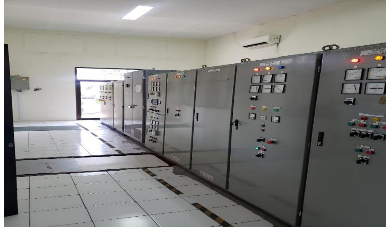
Gambar 2. 17 Panel Utama (ACOS, Transmisi, dan Distribusi) di PH Baru Sumber : Bandara Juwata Tarakan
