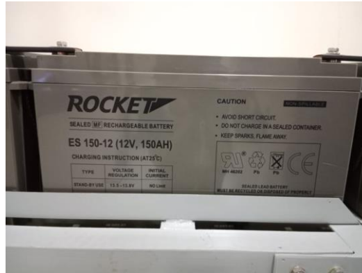
Gambar 3. 5 Baterai ROCKET ES 150-12 Sumber : Bandara Juwata Tarakan
