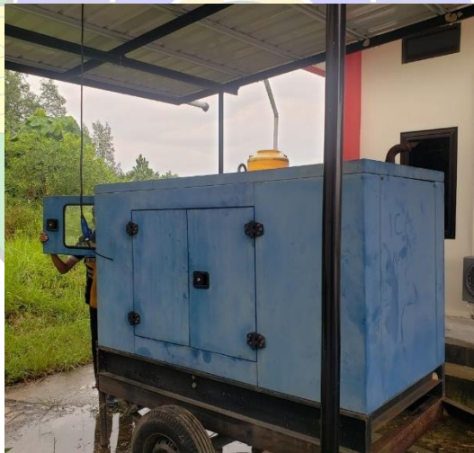
Gambar 2. 9 Genset Mobile 25 kVA Sumber : Bandara Juwata Tarakan
