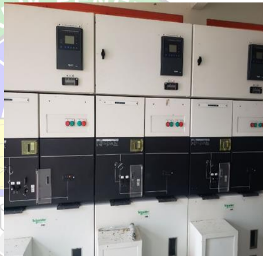
Gambar 2. 13 Cubicle Incoming TM Sumber : Bandara Juwata Tarakan
