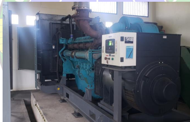
Gambar 2. 6 Genset 1000 kVA di PH Baru Sumber : Bandara Juwata Tarakan
