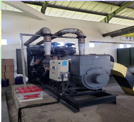
Gambar 2. 8 Genset 500 kVA di PH Baru Sumber : Bandara Juwata Tarakan
