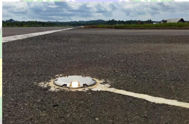
Gambar 2. 19 Runway Edge Light Inset Sumber : Bandara Juwata Tarakan
