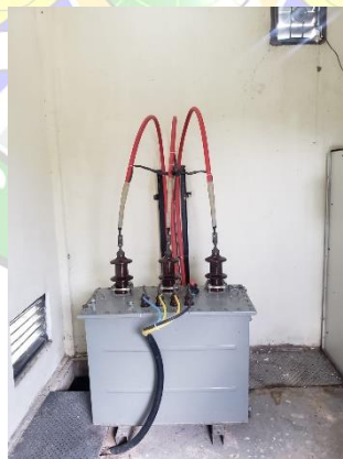
Gambar 2. 15 Trafo Step Down 50 kVA Sumber : Bandara Juwata Tarakan
