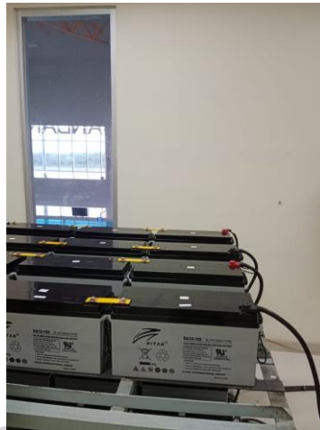
Gambar 4. 2 Baterai UPS 80KVA Pada Gedung Terminal Lantai 3 Sumber : Bandara Juwata Tarakan
