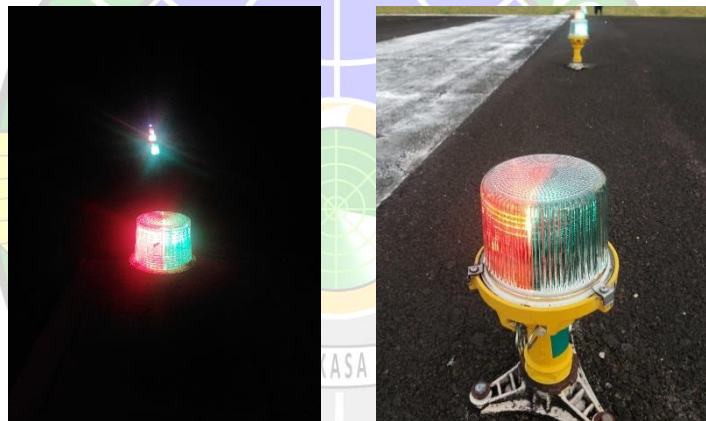
Gambar 2. 21 Threshold Light dan Runway End Light Sumber : Bandara Juwata Tarakan
