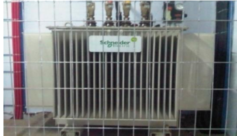
Gambar 2. 29 Transformator Sumber : Bandara Internasional Husein Sastranegara
