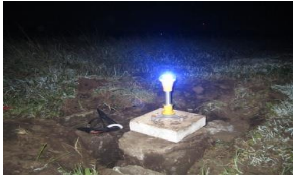
Gambar 2. 12 Turning Area Light Sumber : Bandara Internasional Husein Sastranegara
