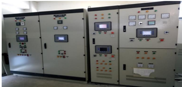
Gambar 2. 32 Genset Control Panel Sumber : Bandara Internasional Husein Sastranegara
