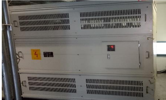
Gambar 2. 31 Transformator 2000 KVA (Step Up) Sumber : Bandara Internasional Husein Sastranegara
