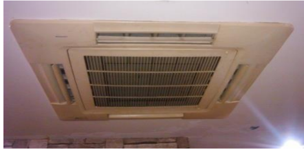
Gambar 2. 25 AC Casette Sumber : Bandara Internasional Husein Sastranegara
