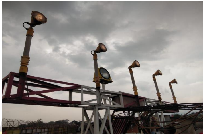
Gambar 2. 2 Approach Light Sumber : Bandara Internasional Husein Sastranegara
