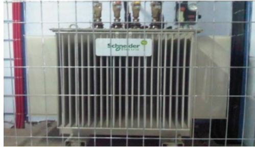
Gambar 2. 30 Transformator 630 KVA (Step Down) Sumber : Bandara Internasional Husein Sastranegara
