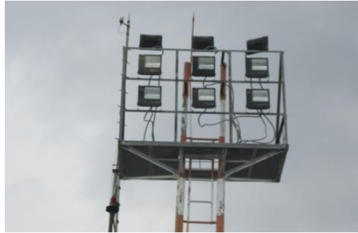
Gambar 2. 21 Apron Flood Light Sumber : Bandara Internasional Husein Sastranegara
