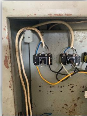
Gambar 3. 34 Kabel Pong pada panel distribusi DVOR dan DME
