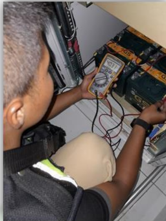
Gambar 3. 40 Pengukuran supply daya pada baterai sesudah kabel tersambung
