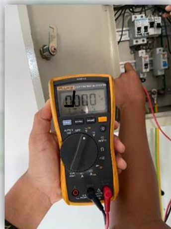
Gambar 3. 37 Pengukuran supply daya pada panel box sebelum kabel tersambung
