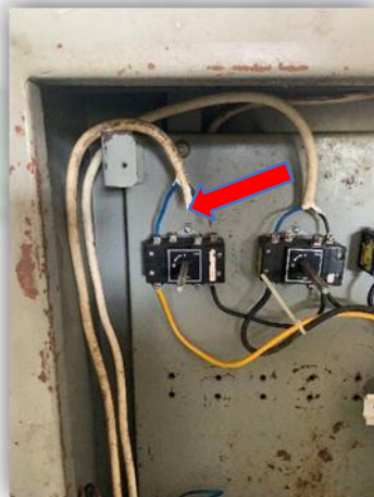
Gambar 3. 35 Kabel Pong pada panel distribusi DVOR dan DME
