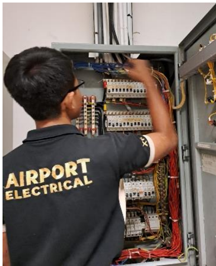
Gambar 5. 10 pemeliharaan panel terminal
