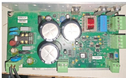
Gambar 4. 4 Modul lampu RGL Sumber : Dokumentasi penulis
