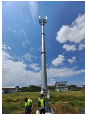
Gambar 2. 18 Flood Light Sumber : Dokumentasi penulis
