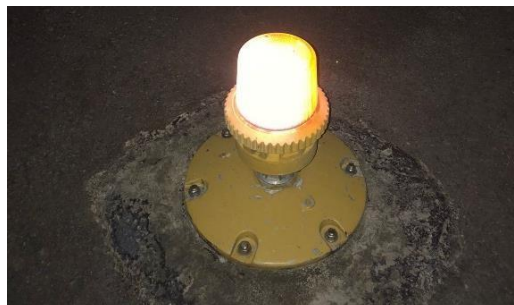
Gambar 2. 3 Runway Edge Light Sumber : Dokumentasi Pribadi
