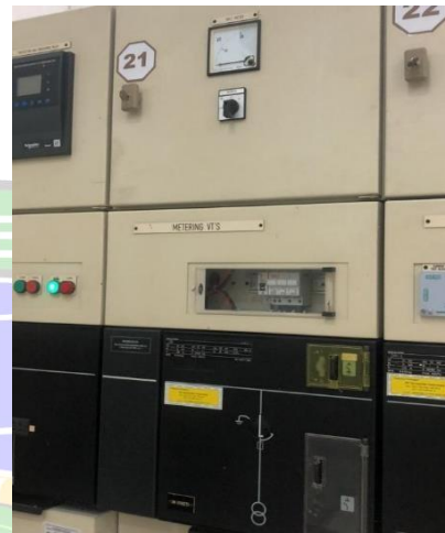
Gambar 2. 20 Panel Metering Sumber : Dokumentasi Pribadi
