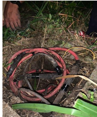
Gambar 4. 2 Kondisi Kabel Sumber : Dokumentasi Pribadi
