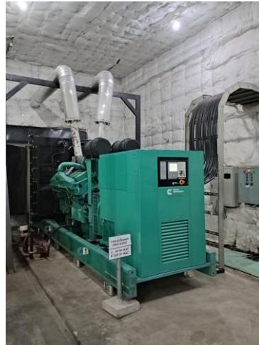
Gambar 2. 16 Genset MPH baru kapasitas 1000 kVA Sumber : Dokumentasi Pribadi
