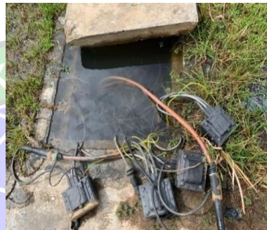
Gambar 4. 1 Kondisi Box Trafo Sumber: Dokumentasi Pribadi
