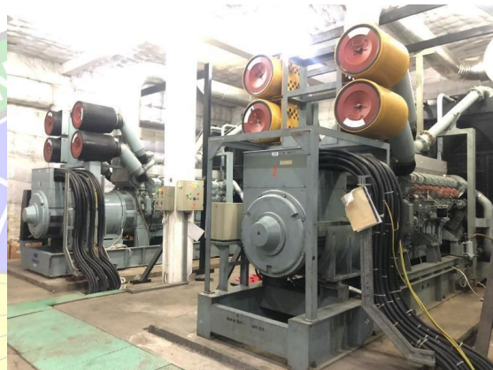
Gambar 2. 15 Genset MPH baru kapasitas 3x2000 kVA Sumber : Dokumentasi Pribadi
