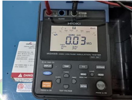
Gambar 4. 8 Hasil Pengukuran Tahanan Isolasi Keseluruhan (looping) CCR Sumber : Bandara Internasional Sultan Hasanuddin Makassar
