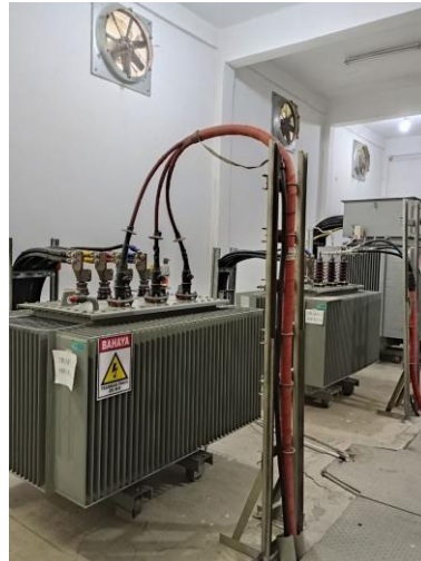
Gambar 2. 14 Transformator Sumber : Dokumentasi Pribadi
