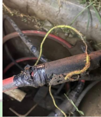
Gambar 4. 3 kondisi Sambungan kabel Sumber: Dokumentasi Pribadi
