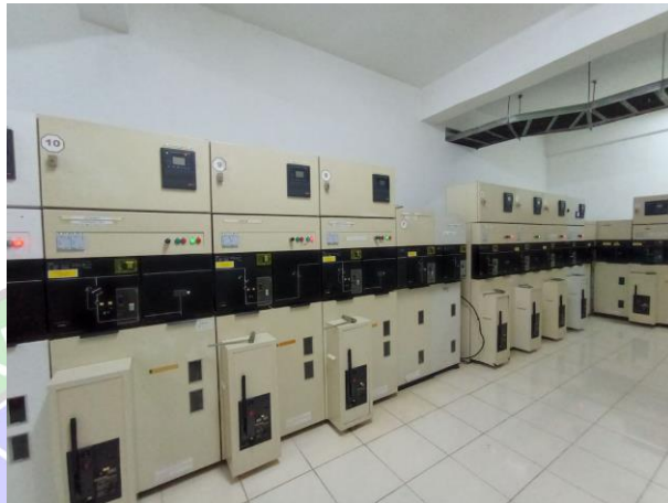
Gambar 2. 18 Panel Kubikel Sumber : Dokumentasi Pribadi
