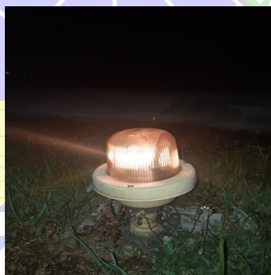
Gambar 3. 2 Runway EdgeLight Sumber : Dokumentasi Penulis
