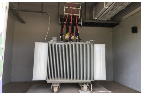
Gambar 2. 8 Trafo PTR Sumber : UPBU A.P.T. Pranoto Samarinda
