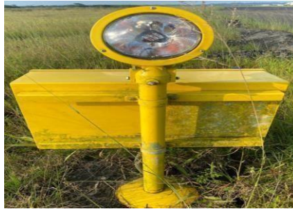
Gambar 2. 29 Kontruksi RTIL Sumber : UPBU A.P.T. Pranoto Samarinda
