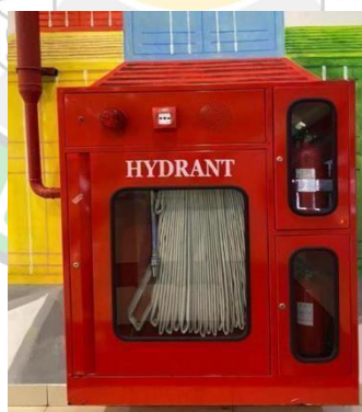
Gambar 2. 21 Hydrant Sumber : UPBU A.P.T. Pranoto Samarinda
