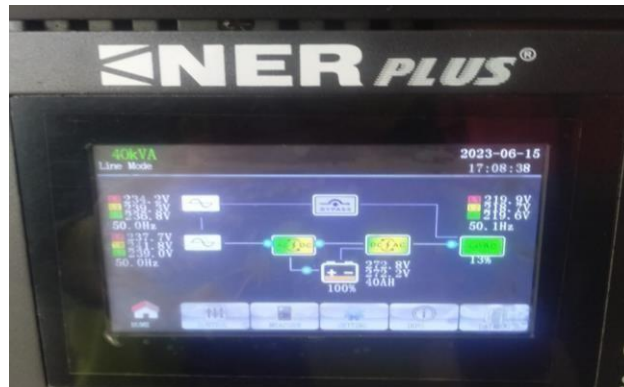
Gambar 4. 1Beban UPS sebelum ditambahkan Beban
