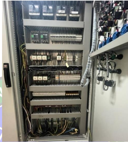
Gambar 2. 9 Panel LVMSB AFL Sumber : Dokumentasi Penulis
