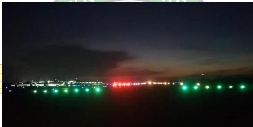
Gambar 3.1 Lampu threshold Sumber : Dokumentasi Penulis
