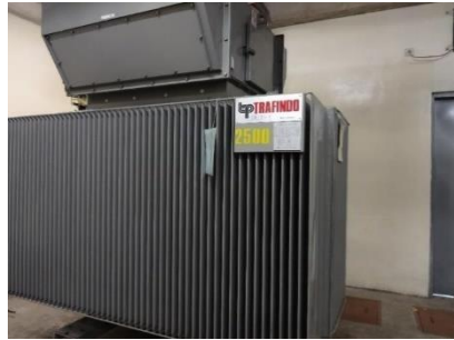
Gambar 2. 6 Trafo Trafindo 2500 kVA
