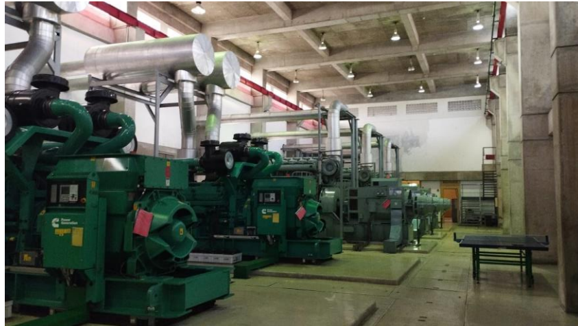
Gambar 2. 2 Generator Set Sumber : Dokumentasi Penulis
