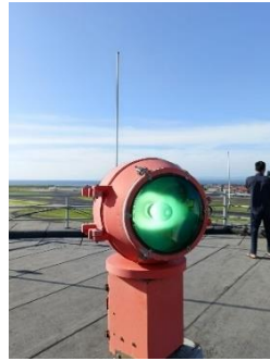
Gambar 2. 33 Rotating Beacon Sumber : Dokumentasi Penulis
