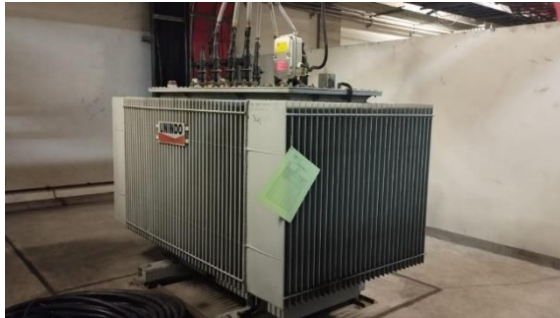
Gambar 2. 5 Trafo Unindo 2000 kVA Sumber : Dokumentasi Penulis
