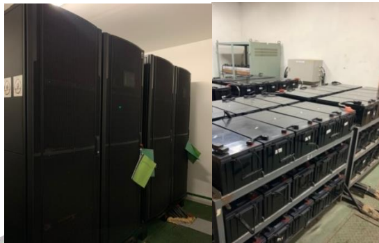
Gambar 2. 3 UPS dan Baterai UPS
