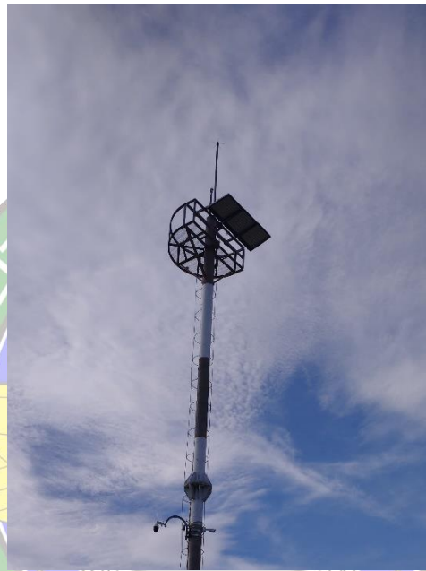
Gambar 2. 43 obstruction light Sumber : Dokumentasi penulis
