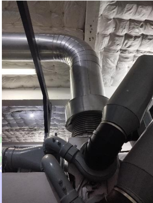
Gambar 3. 10 Exhaust Cooling System Sumber : Dokumentasi Pribadi
