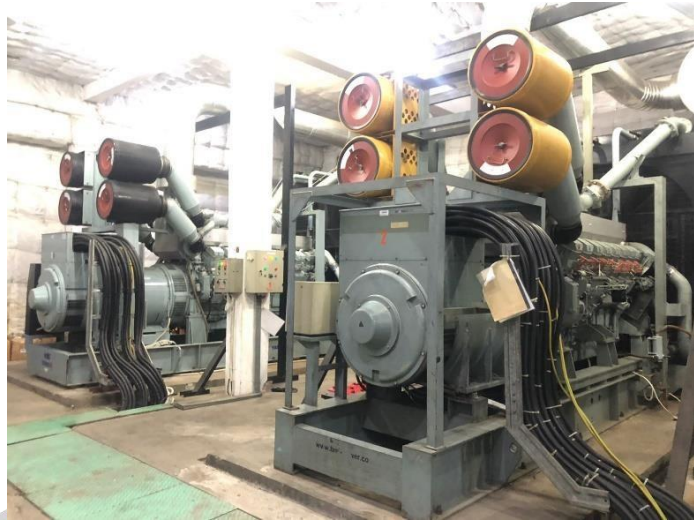
Gambar 2. 13 Genset MPH baru dengan kapasitas 3x2000 kVA
