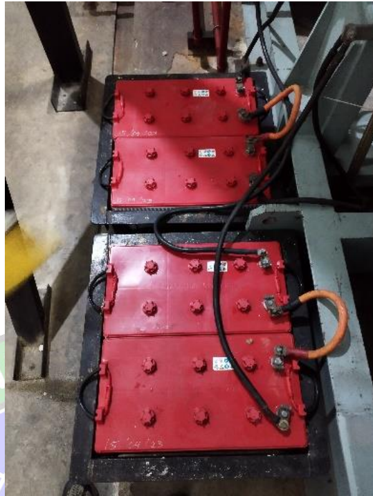
Gambar 3. 3 Baterai Sumber : Dokumentasi Pribadi
