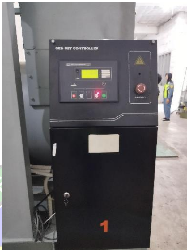
Gambar 3. 9 Control Panel Sumber : Dokumentasi Pribadi
